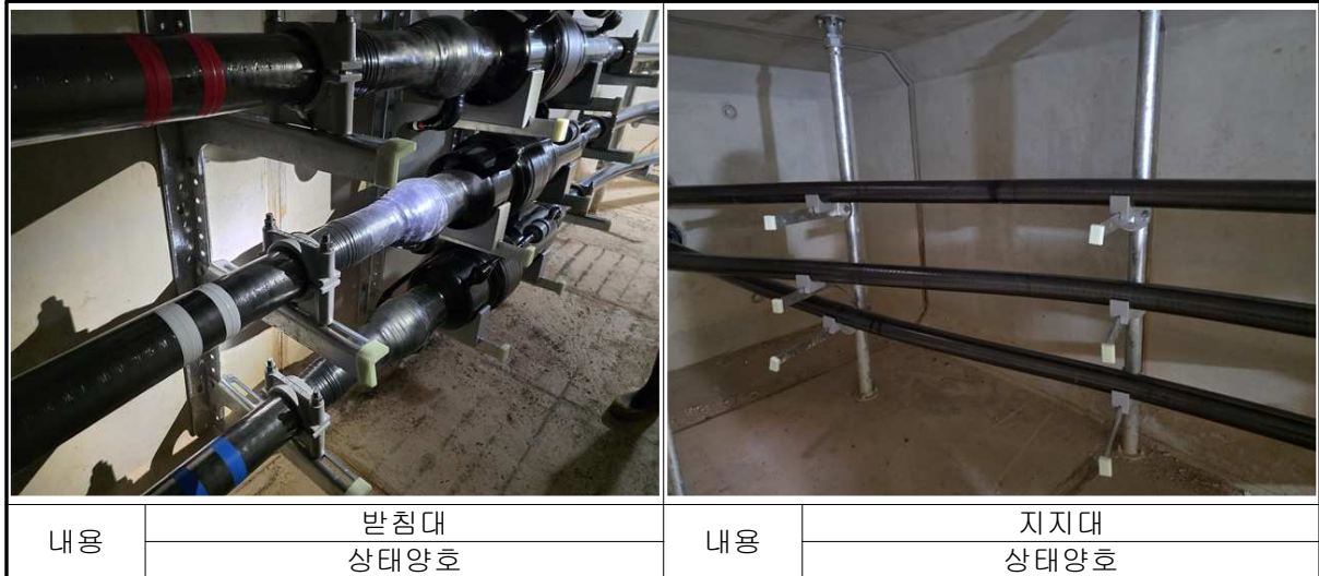
【사진 1.16】 부속 및 부대설비 현황
