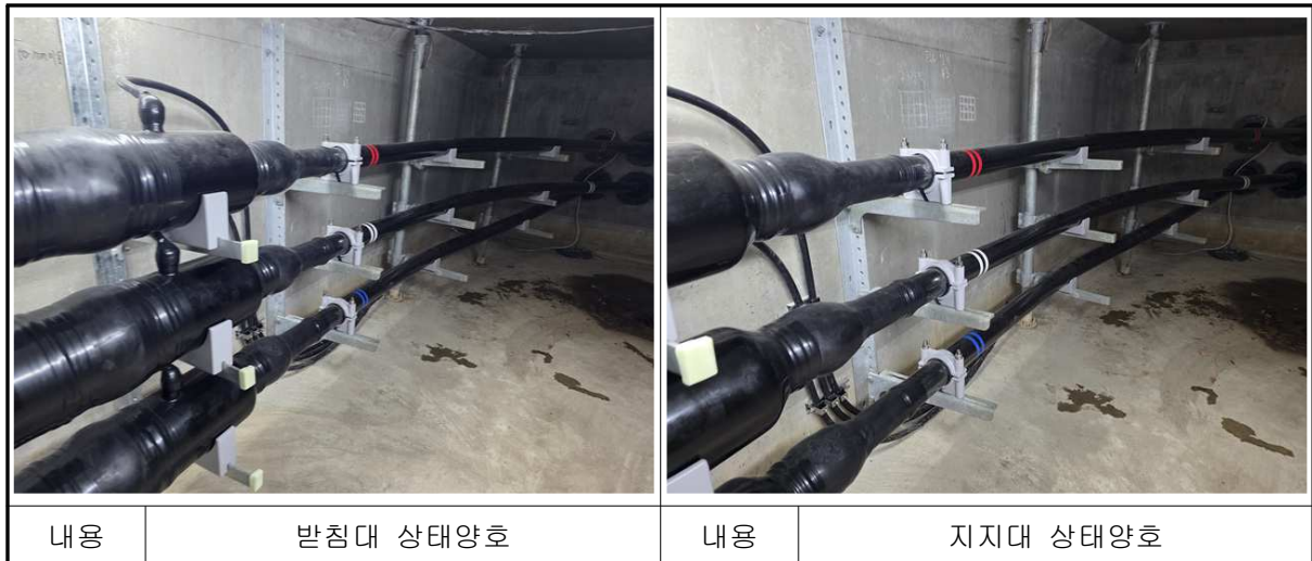
【사진 1.12】 부속 및 부대설비 현황
